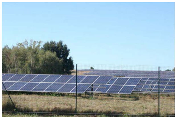
Parc de panneaux photovoltaïques, Daumazan-sur-Arize
